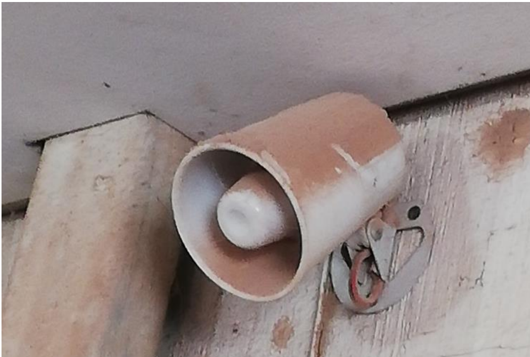
Alarma contra incendios
