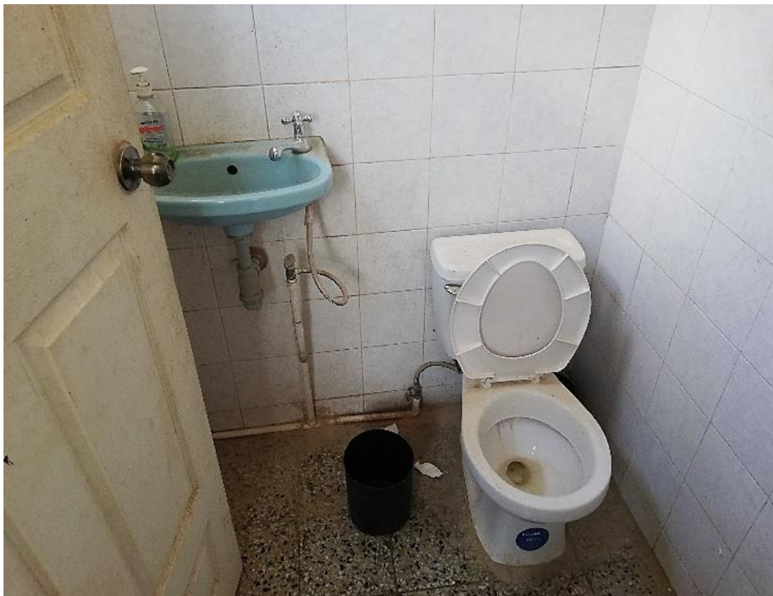
Sanitario del área administrativa
