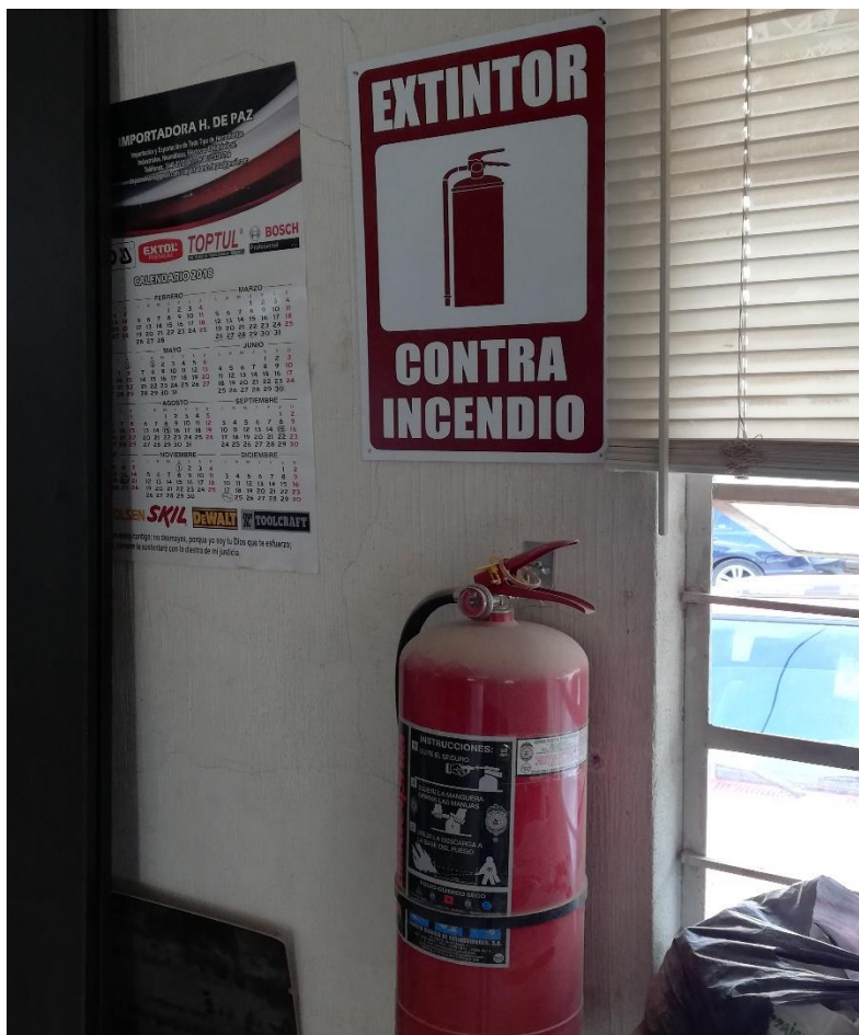
Señal de extintor contra incendios
