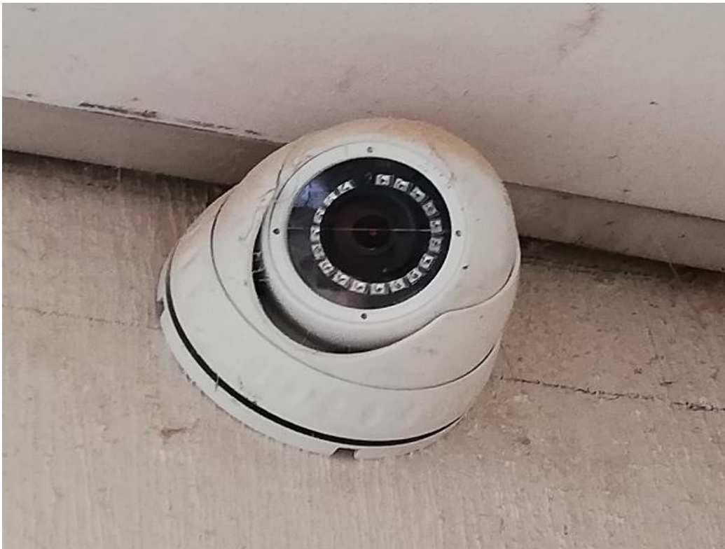
Cámara de seguridad
