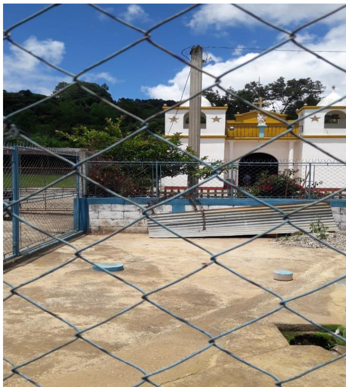
Figura No. 10.1 Pozo de Agua que Potable que abastece a la comunidad Chi-Armira.
