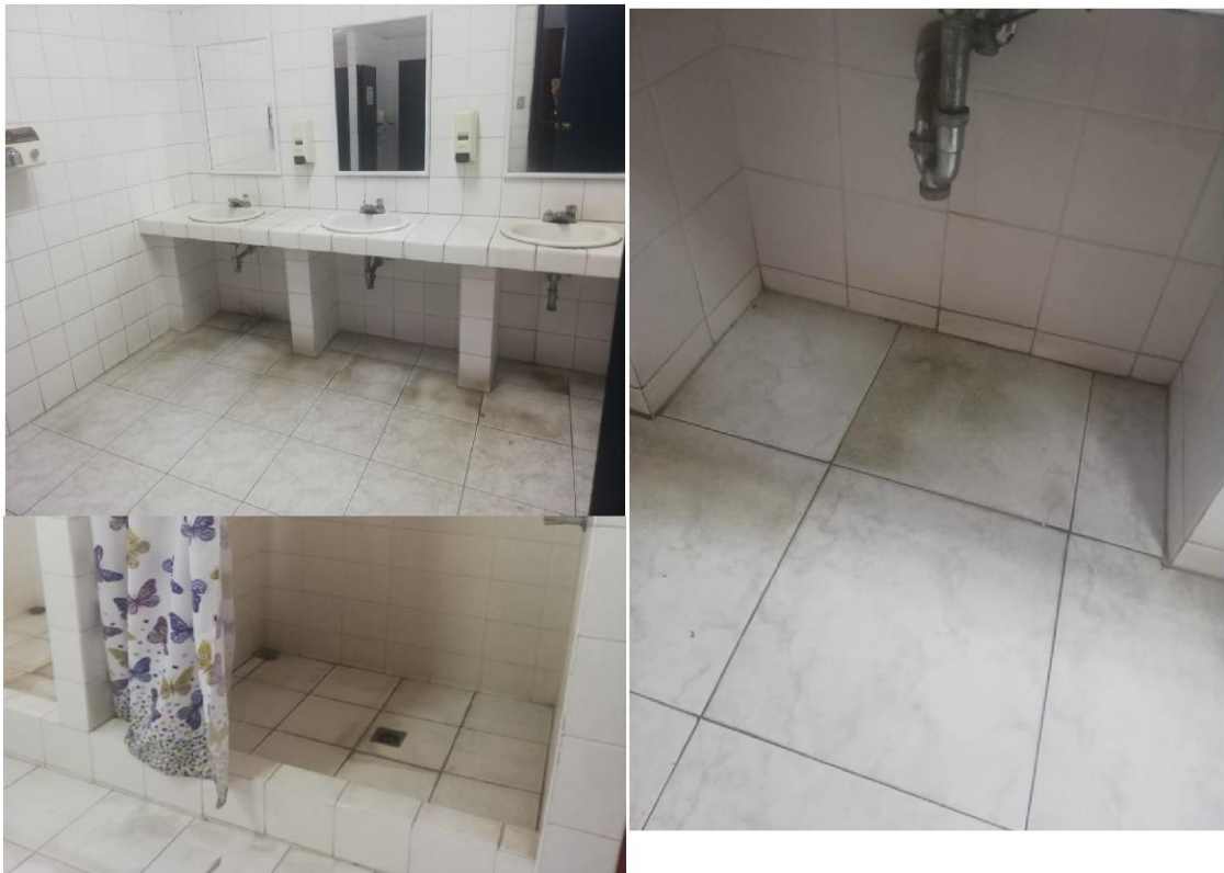
Imagen 26 Sanitarios personal de seguridad y limpieza
