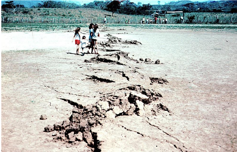
Figuras 12.3.4 Falla del Motagua, Gualán, Zacapa y Rieles deformados Gualán, Zacapa
