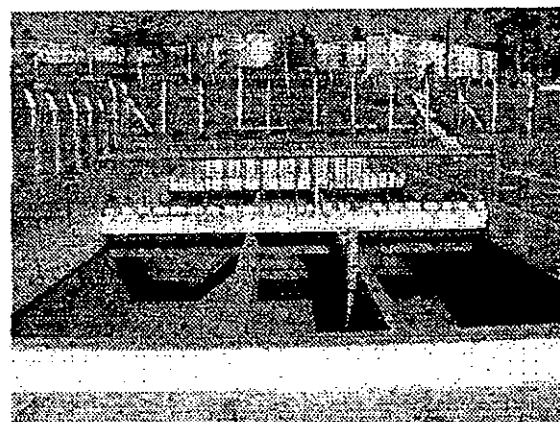
Fotografía 6. Sedimentadores primarios, tipo Imhoff, purgados (vacíados).
