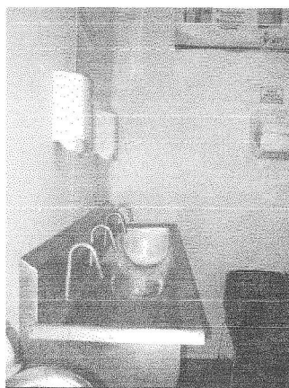
Fotografía No. 8. Lavamanos previo ingreso a Cámaras.
