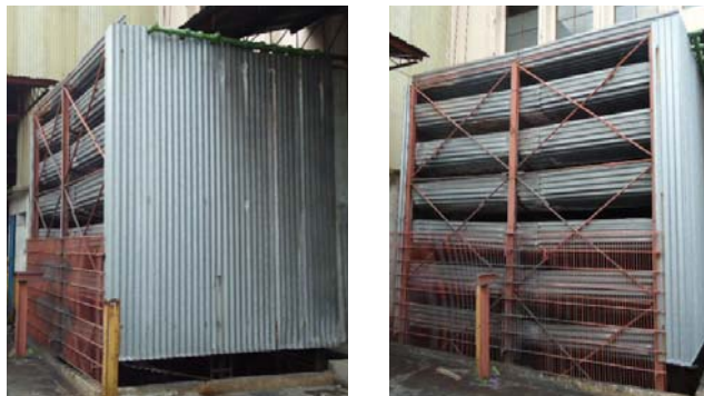
FIGURA 27. Torre de enfriamiento
