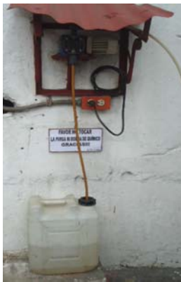
FIGURA 51. Dosificador con químico utilizado para mantener limpia las tuberías de agua
