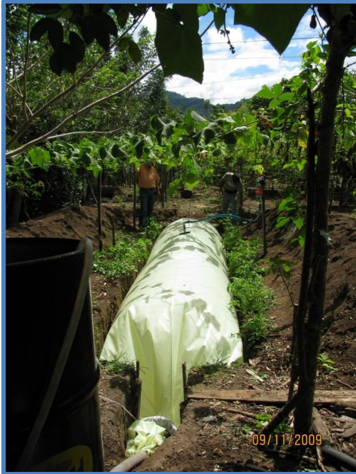
Figura 39: Biodigestor llenado con aire y agua.
