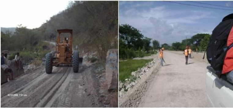
Figura 6: Maquinaria reparando carretera hacia Concepción y trabajos realizados en la pavimentación de Choluteca a Orocuina.
