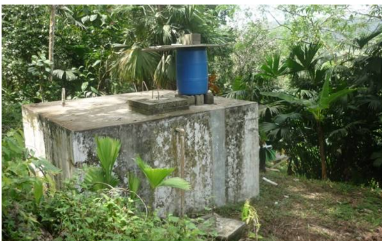
Figura 6. Sistema de almacenamiento de agua de la comunidad de Quebrada Bonita.
