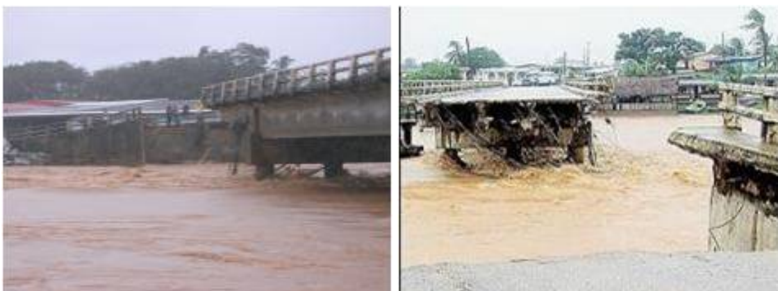
Figura 13. Vistas del colapso del puente sobre el río Indio. Año 2006.
