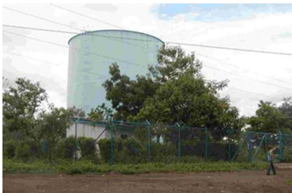
Figura 14 Tanque de Almacenamiento
