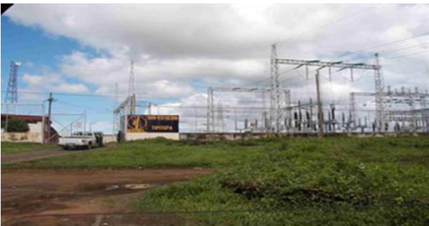
Figura 15 Subestación Eléctrica Tipitapa
