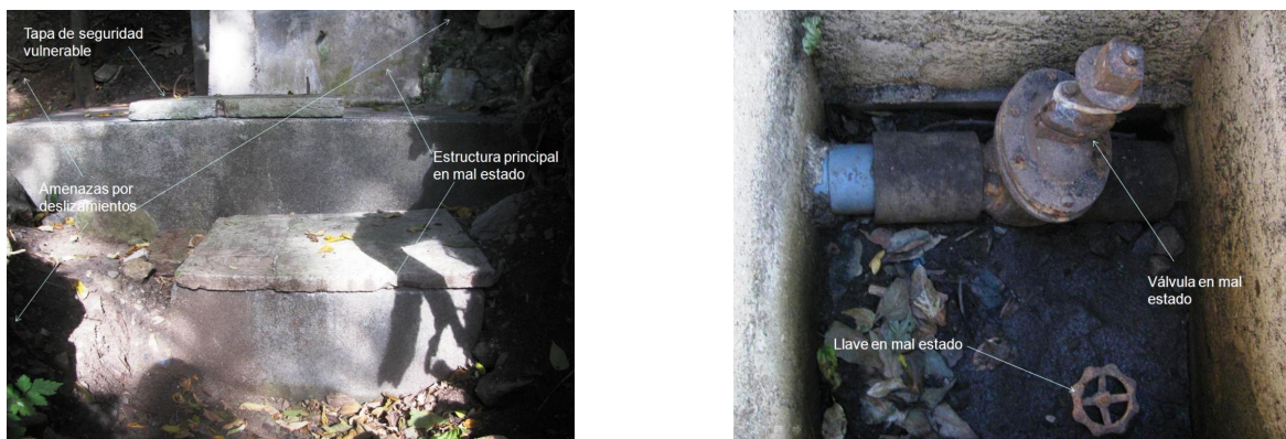
Figura 10. Estado actual de la infraestructura del mini acueducto por gravedad.
