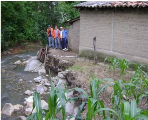
Figura 29. Recorrido por las zonas afectadas por los desborde de ríos.
