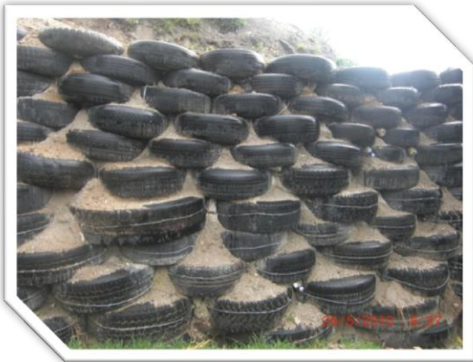
Figura 74. Muro de contención con llantas usadas. Escuela Caquixá, aldea El Progreso, San Carlos Sija.
