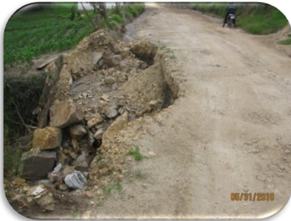
Figura 15. Tramo dañado durante la tormenta Agatha 2010, en la carretera que conduce de la cabecera municipal a la aldea Rodeo.
