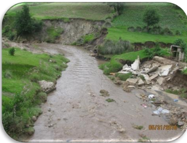
Figura 17. Infraestructura dañada durante la tormenta Agatha 2010, por mala ubicación. Aldea San José Chicalquix, San Carlos Sija.
