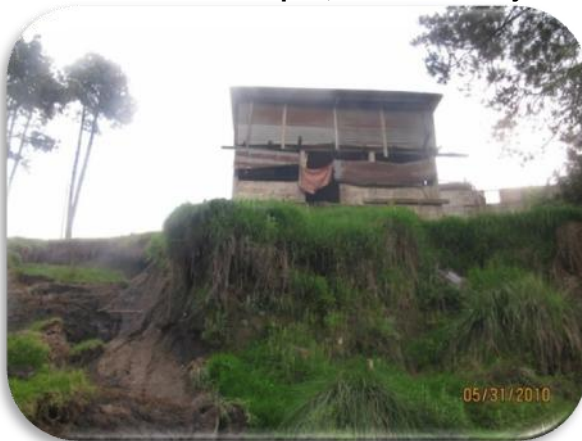
Figura 18. Vivienda ubicada en un punto de riesgo.
