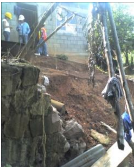
Figura 14: Áreas afectadas recientemente por deslizamientos. Fuente: Estación de Bomberos, base # 23, Valle de Ángeles.
