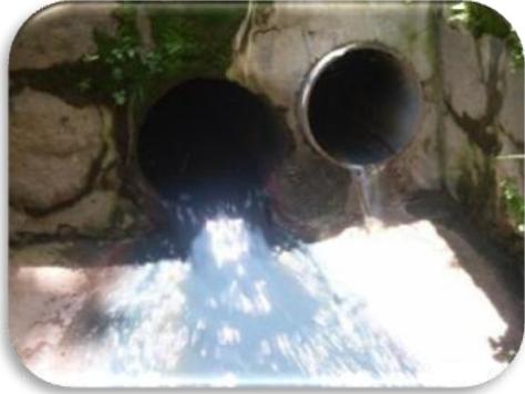
Figuras 15: Aguas residuales sin tratamiento, desfogue de dichas aguas.
