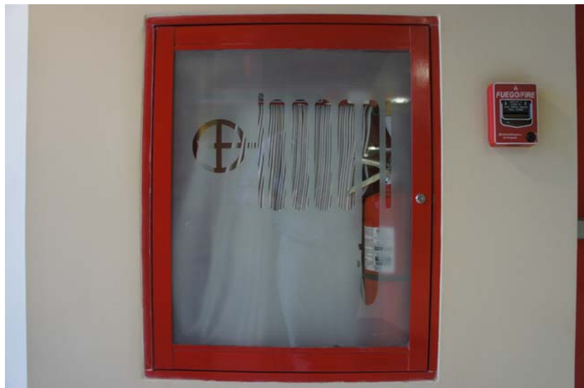
Figura No.5, Boca de incendio equipada y palanca de emergencia
