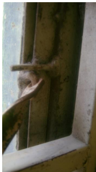
Fotografía No. 12: Deterioro de ventanas. (Fuente: Elaboración propia)
