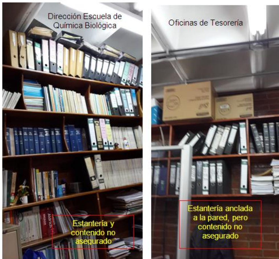
Imagen 2: Anclajes del mobiliario de las oficinas y seguridad de los contenidos
