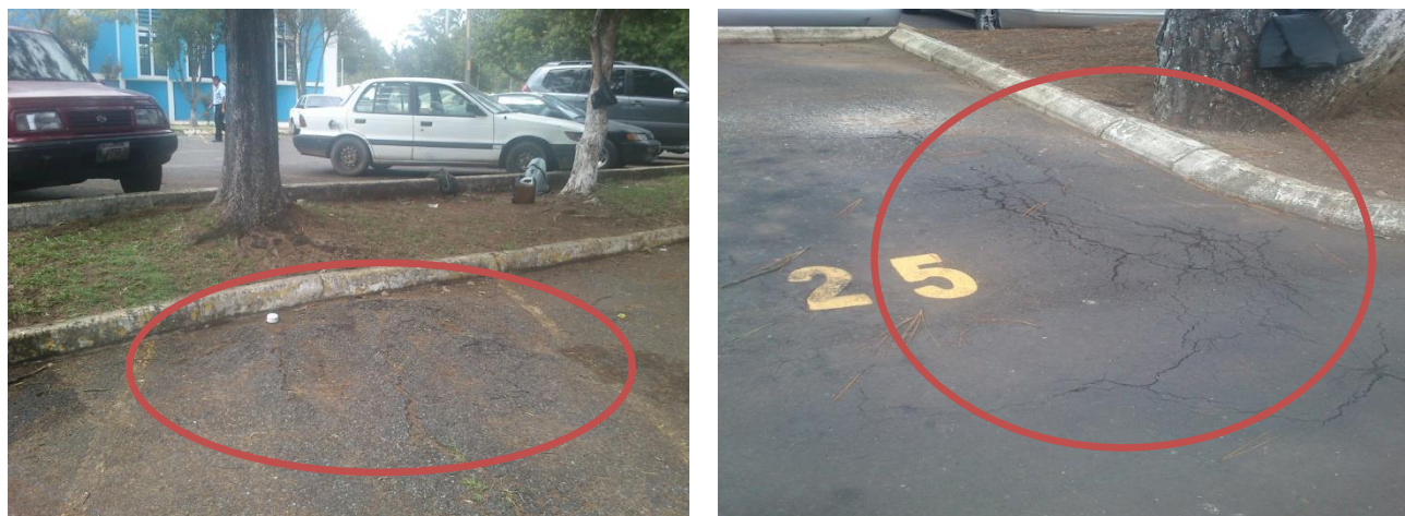
Imagen 5: Asfalto dañado en los parqueos
