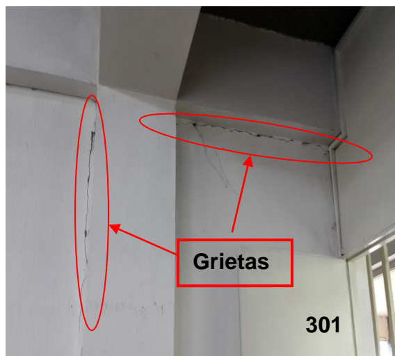
Imagen 5: Muros con grietas Química General
