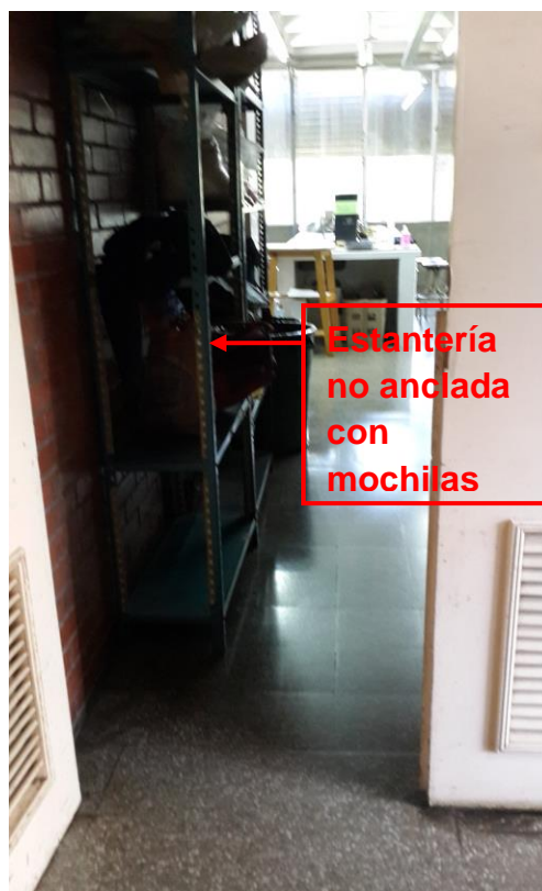
Imagen 4: Estanterías no ancladas a la pared ubicadas en la entrada del laboratorio
