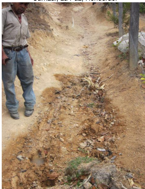
Imagen 3. Tubería dañada Carrizal, La Paz, Honduras.
