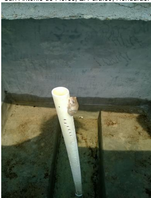
Imagen 2. Tanque hipoclorador sin uso. San Antonio de Flores, El Paraíso, Honduras.
