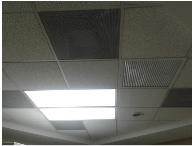
Figura 17. Rejillas de equipo de aire acondicionado de conductos
