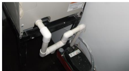
Figura 16. Tubería de drenaje y bomba de succión de condensado de un equipo
