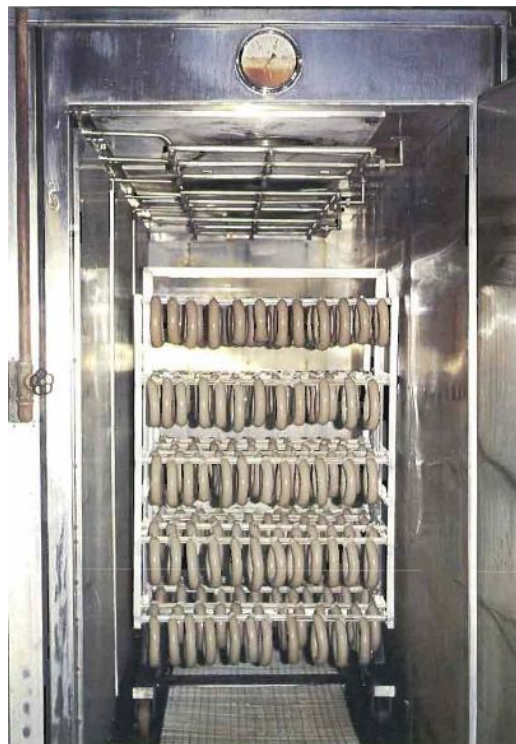
Imagen No. 5 Cámara de Cocción
