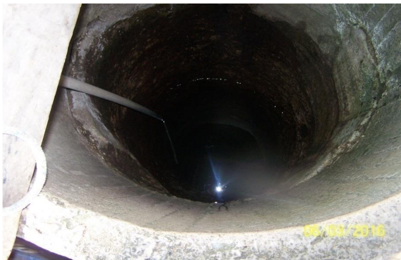
Fotografía 11. Pozo mixto en Aldea La Curvina
