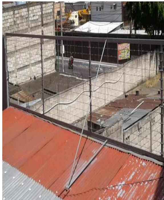
Barreras físicas instaladas en los techos de la empresa para limitar el acceso de personal no autorizado
