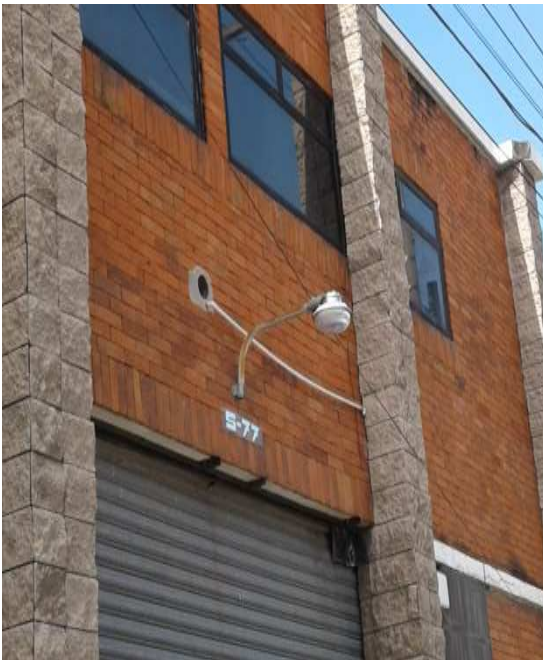
Luces instaladas en el frente de la empresa
