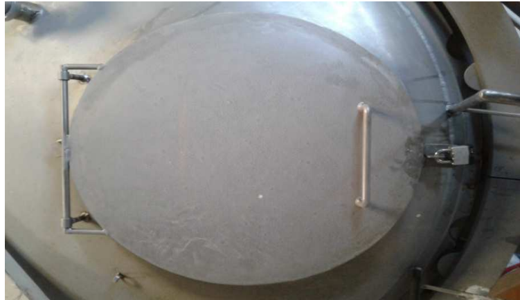
Tanque de almacenamiento de producto con candado
