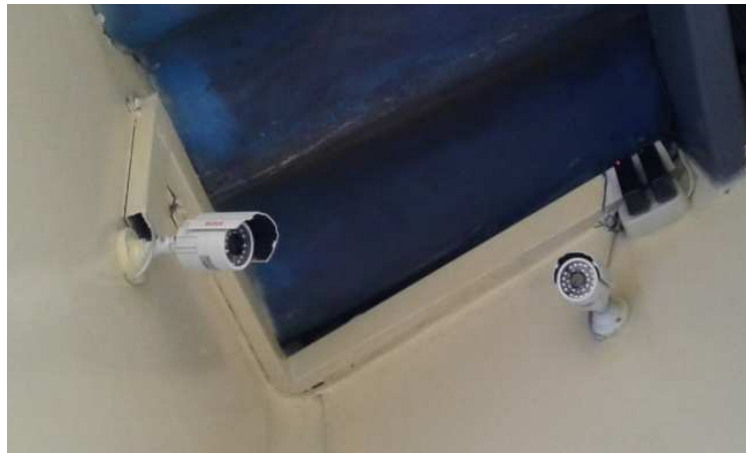
Cámaras de seguridad instaladas
