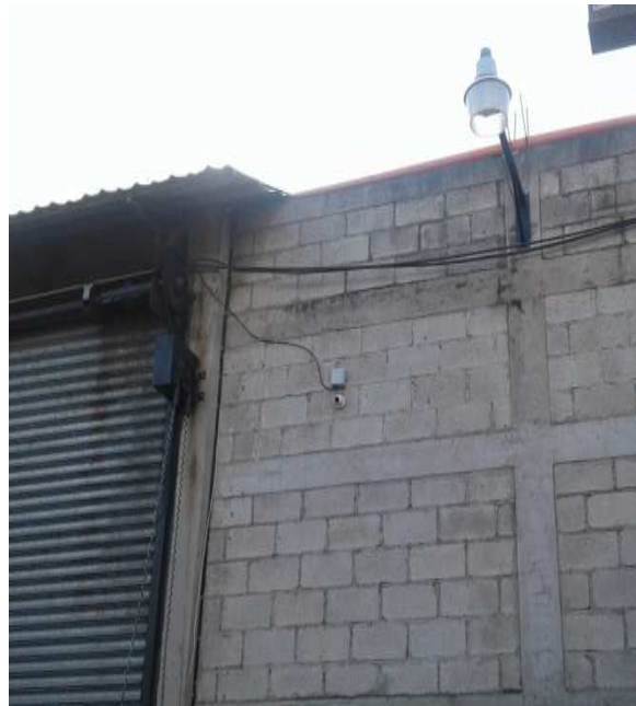
Luces instaladas en la parte trasera de la empresa
