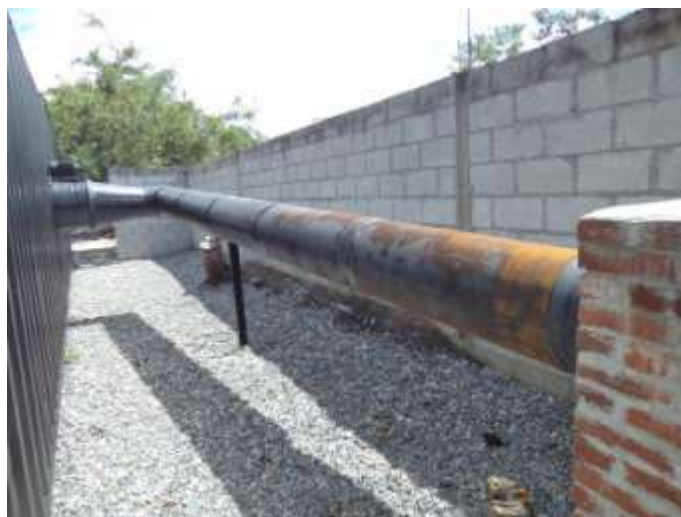
Figura 18. Ducto conductor de calor
