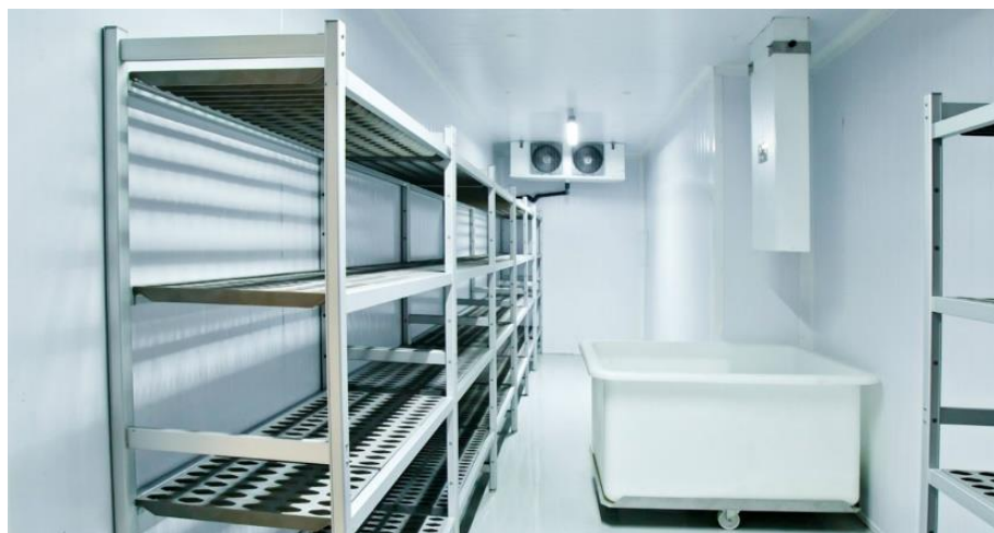
Figura 7. Producto refrigerado de un servicio de alimentación.
