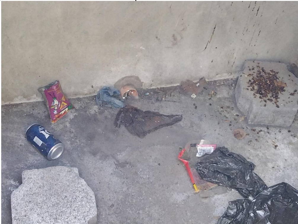
Imagen No. 6 Contaminación en tanques de distribución
