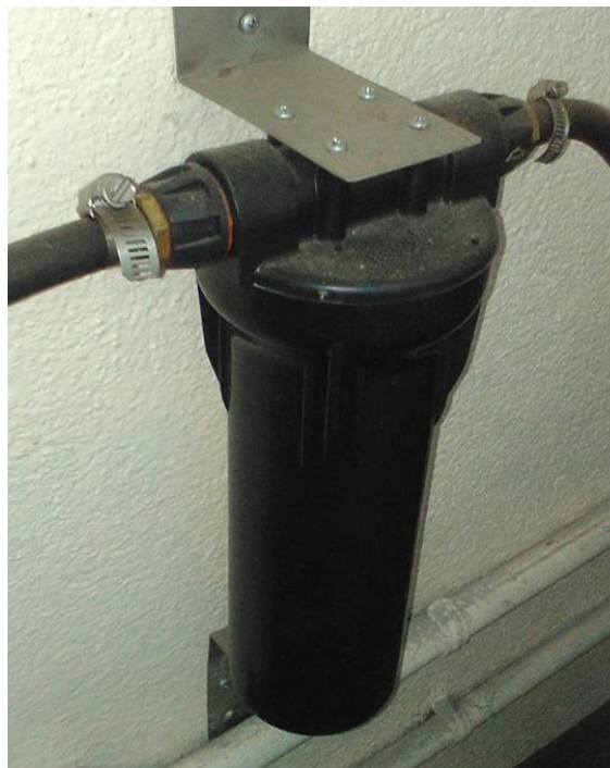
Figura No. A1-6 Filtro generador de agua desmineralizada
