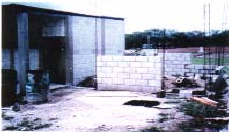
Inicio de la construcción en las instalaciones de la Facultad de Humanidades, Sección Jalapa. (Fuente Facultad de Humanidades, Sección Jalapa. Universidad de San Carlos de Guatemala).
