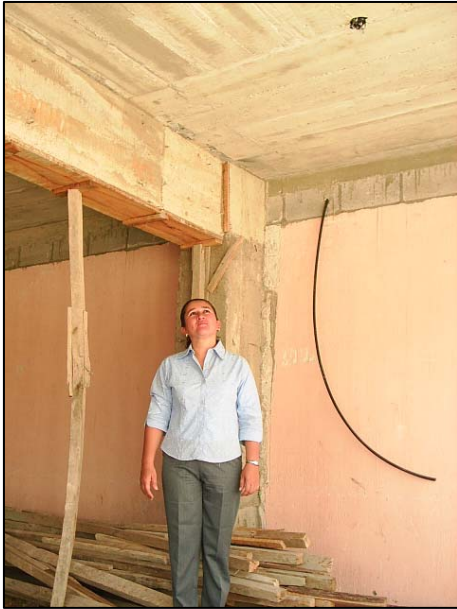
Foto 11. Vista interior del techo fundido Incluye instalación eléctrica
