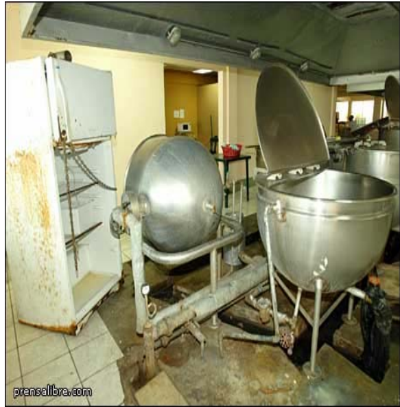
La cocina refleja el mal estado en que se encuentra la totalidad del hospital. Sanatorio Antituberculoso San Vicente, ciudad de Guatemala. Foto Prensa Libre: Mario Linares.
