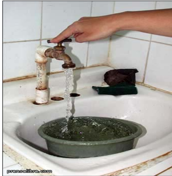
La falta de mantenimiento conlleva al desperdicio de recursos. Hospital Nacional de Coatepeque, Quetzaltenango. Foto Prensa Libre: Edgar Girón.
