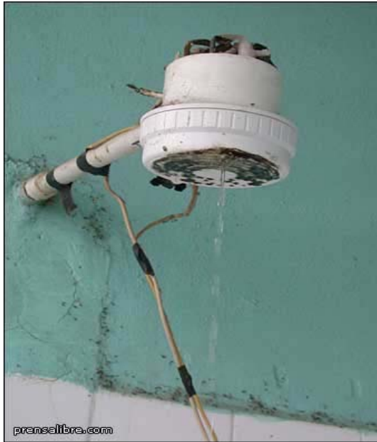
Duchas en mal estado son un foco de contaminación. Hospital Nacional de Coatepeque, Quetzaltenango. Foto Prensa Libre: Edgar Girón.
