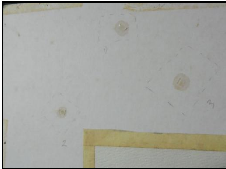
Figura 7. Manchas de Agua
