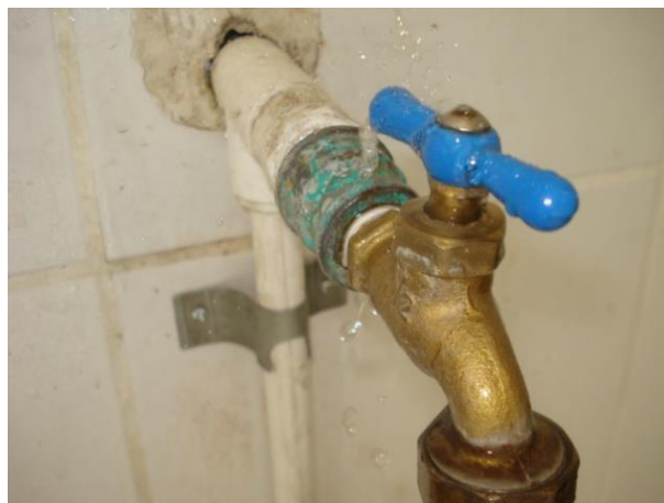
Figura 36. Chorro con fuga de agua
