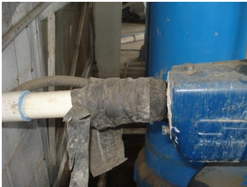
Figura 37. Tuberías en mal estado
