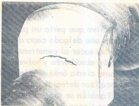
Señal producida por un tinte penetrante, la cual revela una grieta en una parte del bastidor de una prensa punzonadora.
