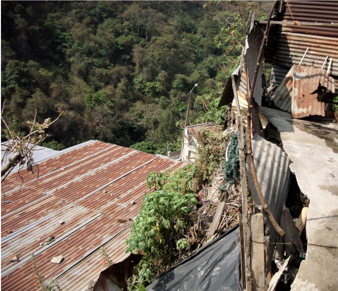
Figura 20. Láminas y piso dañados
