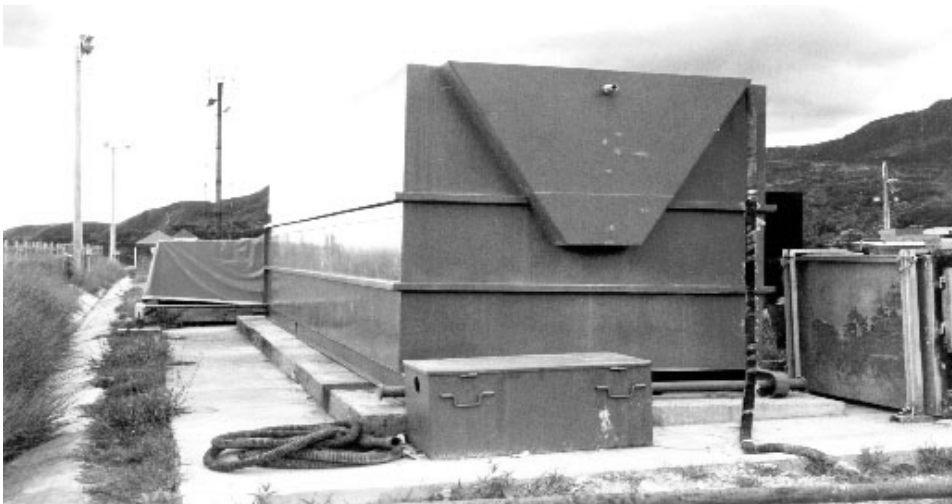
Fotografía 6. Planta de tratamiento 2
