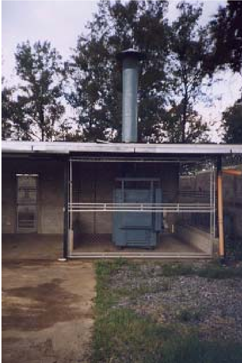
Vista frontal del incinerador
