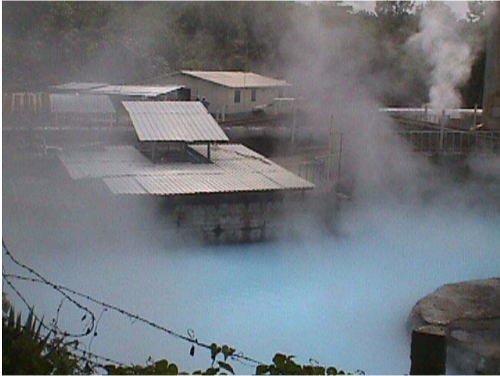
VISTA DEL CARCAMO DE CONDENSADO (POZO)
