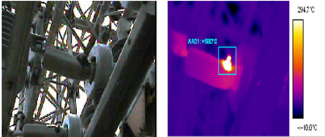
Figura 18. Termografía infrarroja en puntos de conectividad de un reconector
