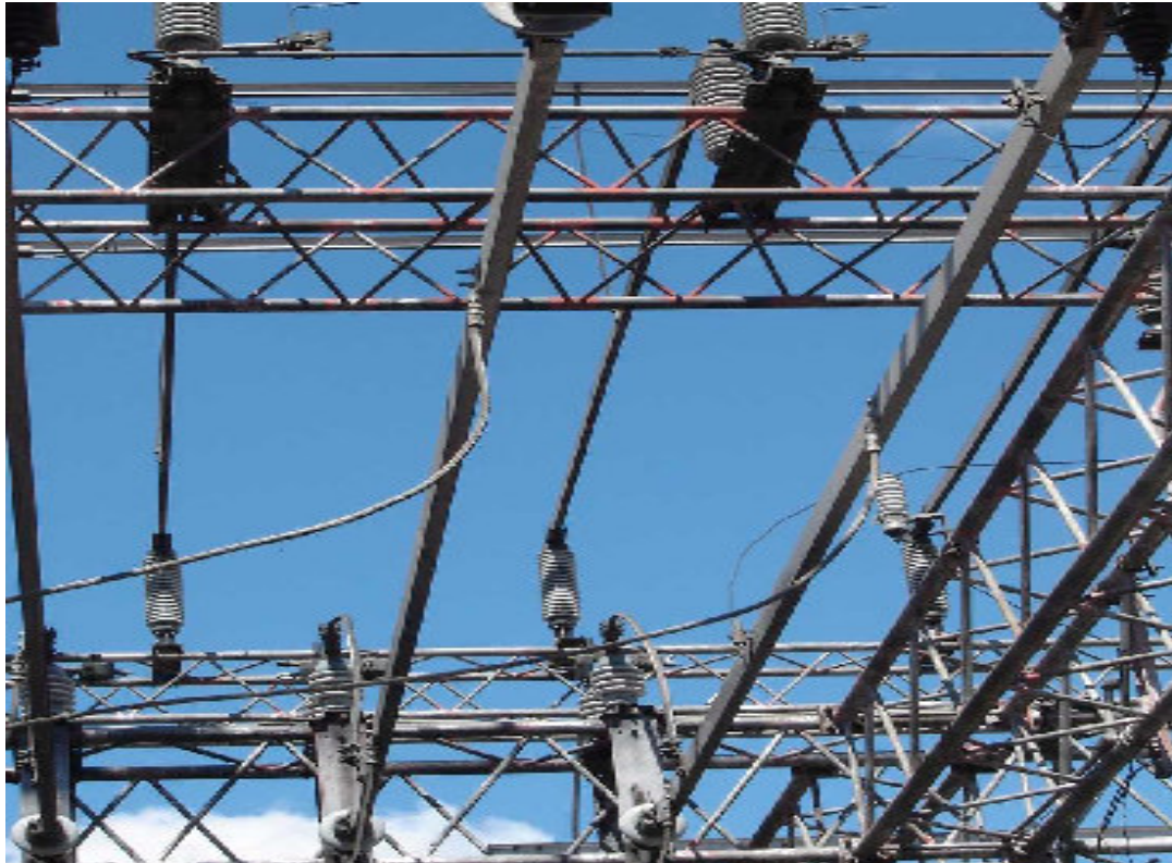
Figura 8. Barras colectoras en una subestación de distribución
