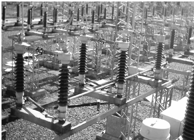
Figura 4. Foto de seccionadores horizontales instalados en subestación Escuintla 1
