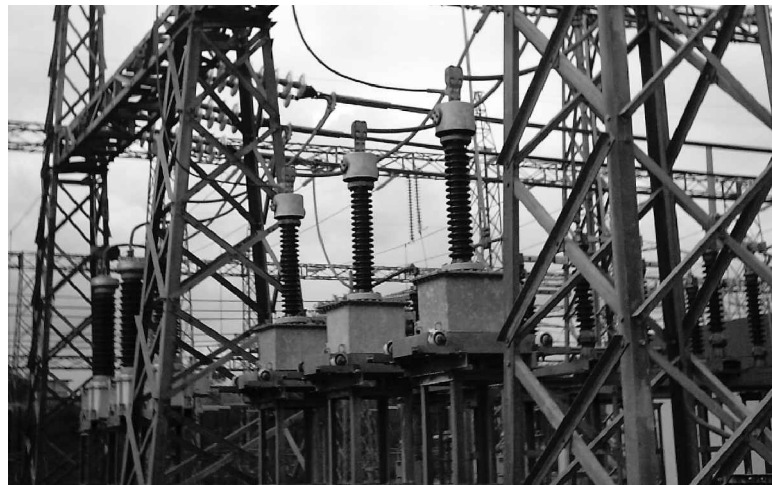
Figura 7. Foto de transformadores de potencial instalados en subestación Guatemala norte
