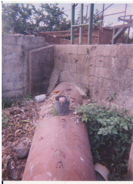
Tubería a Presión
