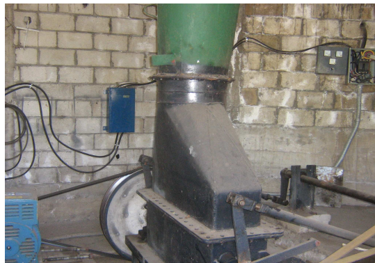
Generador y tableros
