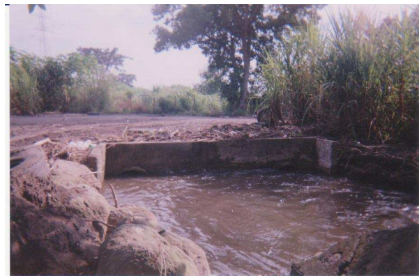
Toma de agua con obra de cierre
