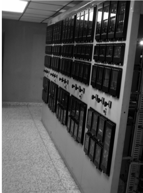
Figura 9. Relevadores electromecánicos de la Hidroeléctrica Chixoy.
