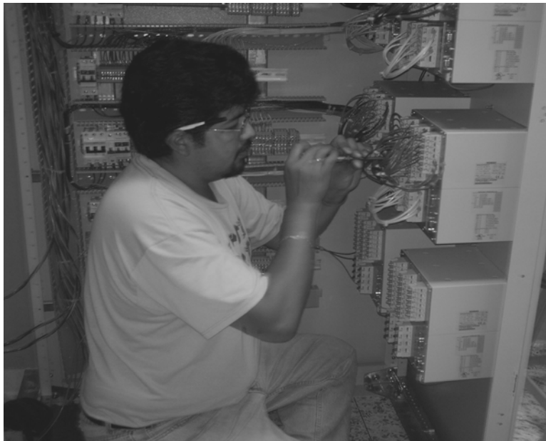
Figura 70. Conexión de los relevadores a las tablillas.
