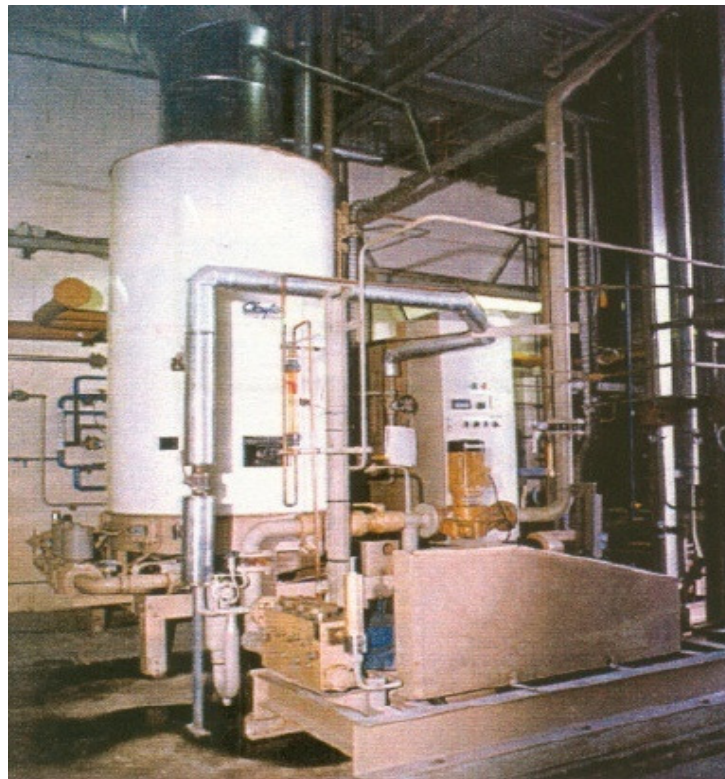
Figura 1. Caldera acuatubular Clayton
