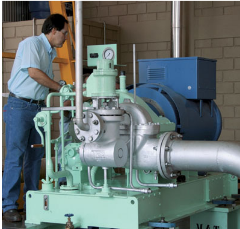
Figura 2. Turbina propuesta de baja presión y temperatura Marca TGM Modelo TG-320 Obsérvese la tubería de entrada de vapor y el generador acoplado
