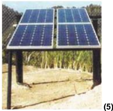
Figura 9.2 Conjunto de paneles fotovoltaicos típico y su estructura metálica de soporte.
