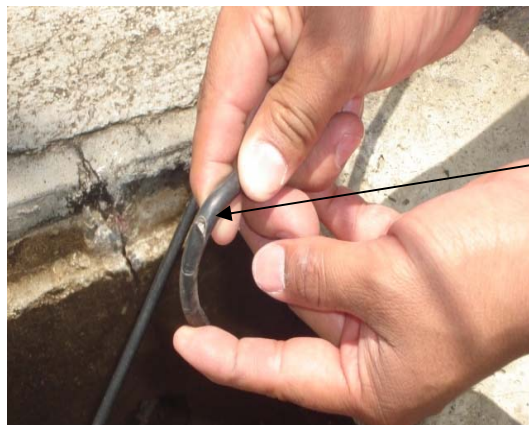
Figura 43. Cable abierto en distribución interna
