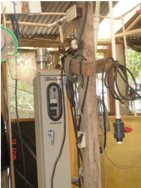
Fotografía 15: Ubicación de contadores de energía eléctrica y situación actual Imagen CEMA Monterrico, Fuente propia
