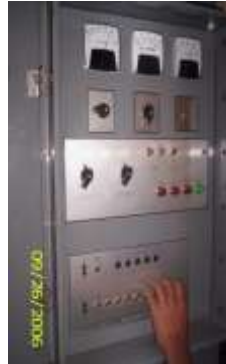
Figura 8. Panel de Banco de carga.
