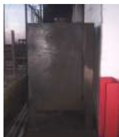
Figura 24. Almacenamiento de combustible.
