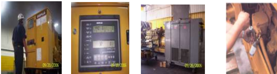
Figura 41. Preparación para entrega 2: Monitoreo general de la planta, parámetros del panel de control, banco de carga para la prueba de potencia y toma de muestra de aceite.
