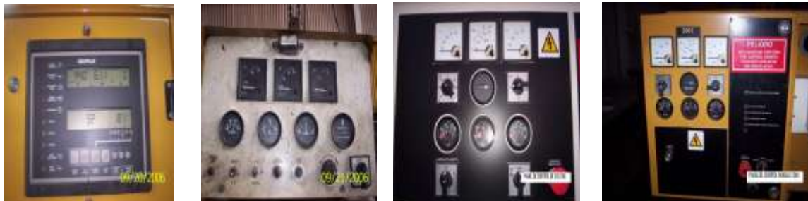
Figura 27. Diversos tipos de paneles de control.
