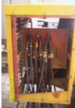
Figura 7. Conexión de Banco de carga.
