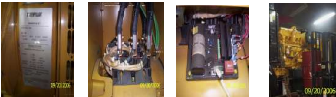
Figura 40. Preparación para entrega 1: placa de datos, conexión de bornera, conexión de regulador de voltaje, suministro de combustible
