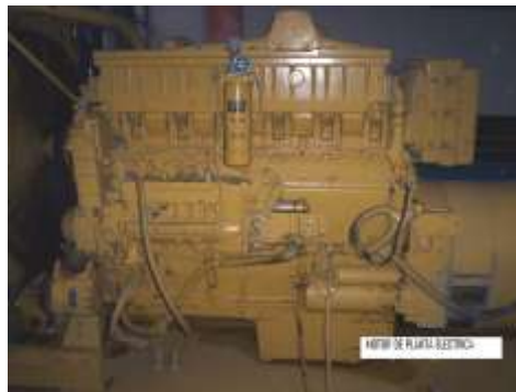
Figura 17. Vista de motor diesel 2.
