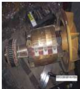
Figura 10. Prueba de Aislamiento del rotor
