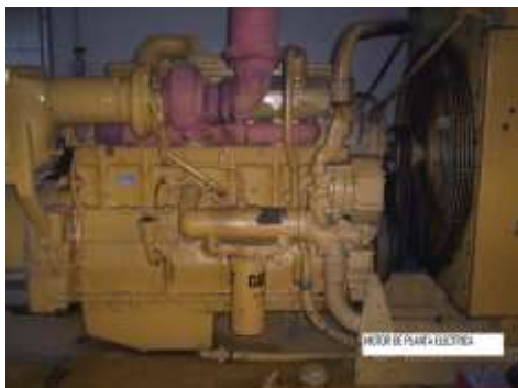
Figura 16. Vista de motor diesel 1.
