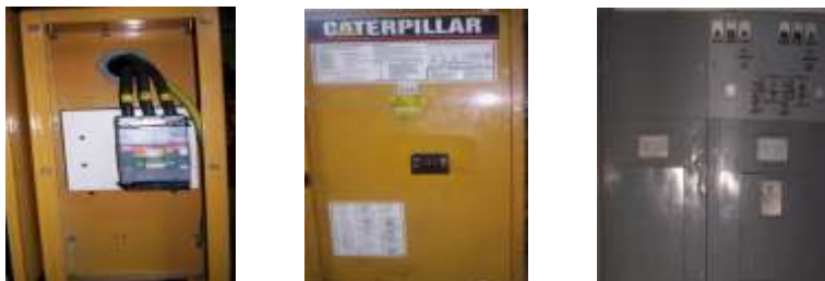
Figura 28. Interruptor automático de salida
