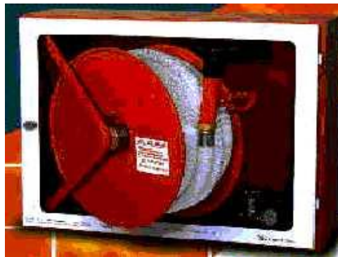
Figura 196 Hidrante con su respectiva manguera
