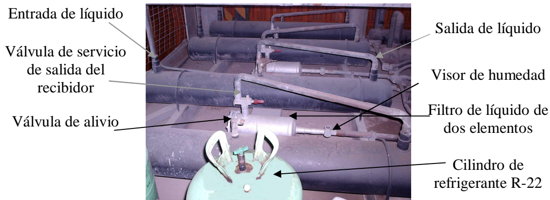
Figura 161 Cuatro recibidores de líquido de una unidad condensadora de cuatro compresores de 40 hp
