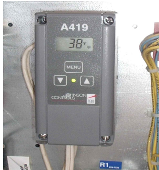
Figura 178 Instalación de un termostato electrónico dentro de una unidad condensadora
