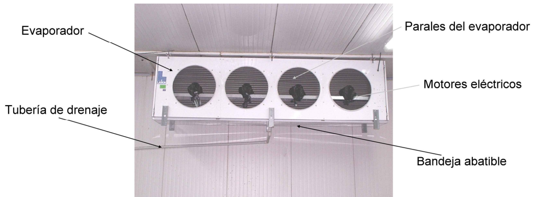
Figura 186 Evaporador en servicio de preservación
