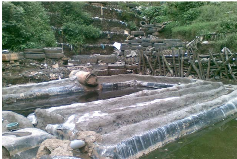
Tanques de planta de tratamiento de lixiviados
