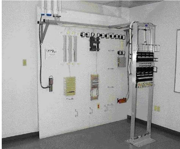
Figura 10. Armario para cableado estructurado
